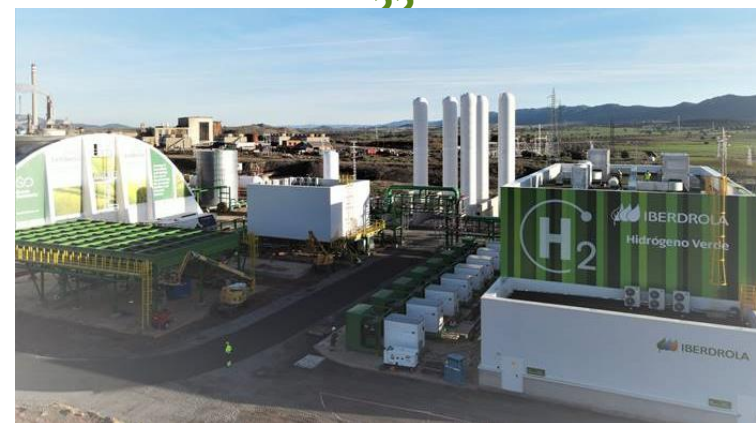
Planta de H2 verde industria Puertollano (20 MW)
