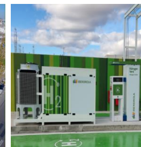
Planta de H2 verde movilidad Barcelona (2,5 MW)
